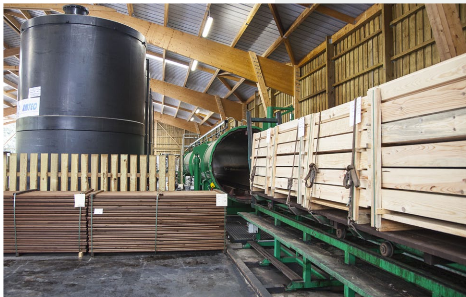
Nouvelle station de traitement autoclave, Ets Ribeyre SATB, Linxe (40)
